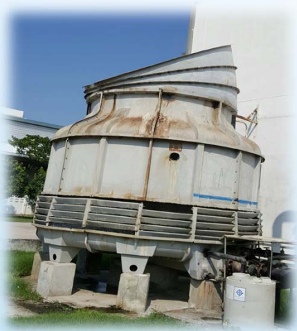
Cooling motor fan
