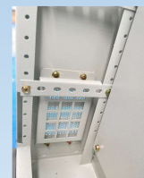
13 - ชั้นบันไดยึดสายไฟ - ตระแกรงกันฝุ่น - ช่องระบายอากาศด้านข้าง
