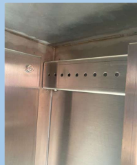
7 - ชั้นบันไดยึดสายไฟ
