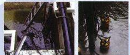
Pumping waste water in factory ปั๊มน้ำเสียในบ่อบำบัดน้ำเสียของโรงงาน
