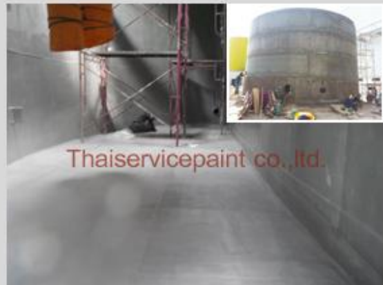
Thaiservicepaint co.,ltd. ชื่องาน :งานเคลือบ FRP พื้นที่ใช้งาน :แท้งค์เก็บสารเคมี Location :นิคมฯ โรจนะ-อยุธยา
