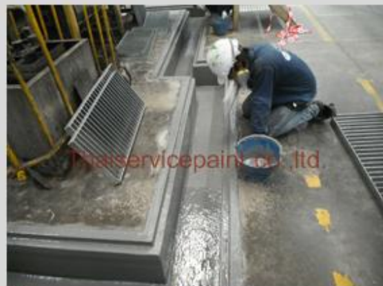
ชื่องาน :งานเคลือบ FRP พื้นที่ใช้งาน :รางระลายน้า Gutter Location :ระยอง
