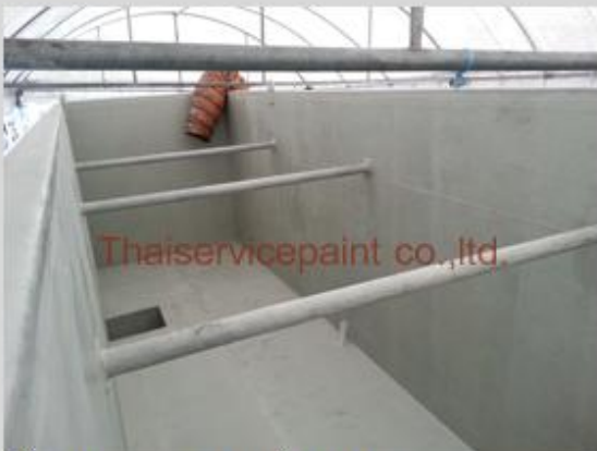
ชื่องาน : งานเคลือบ FRP พื้นที่ใช้งาน : แทงค์เก็บสารเคมี Location : นิคมฯ สยามอีสเทิร์น
