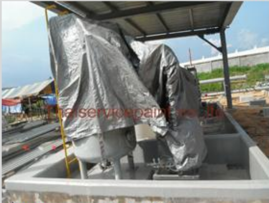
ชื่องาน :งานเคลือบ FRP พื้นที่ใช้งาน :พื้นที่สำหรับวางแทงค์เก็บสารเคมี Location :นิคมฯ อีสเทิร์นซีบอร์ด-โรงไฟฟ้า
